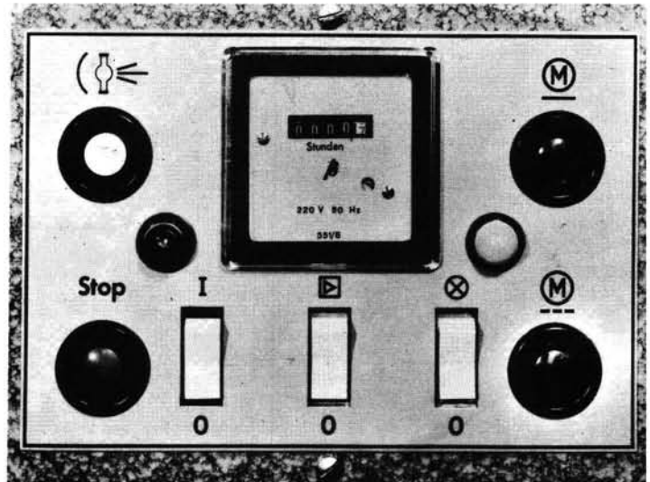
Bild 3 Projektor-Schalttafel mit Betriebsstundenzähler
