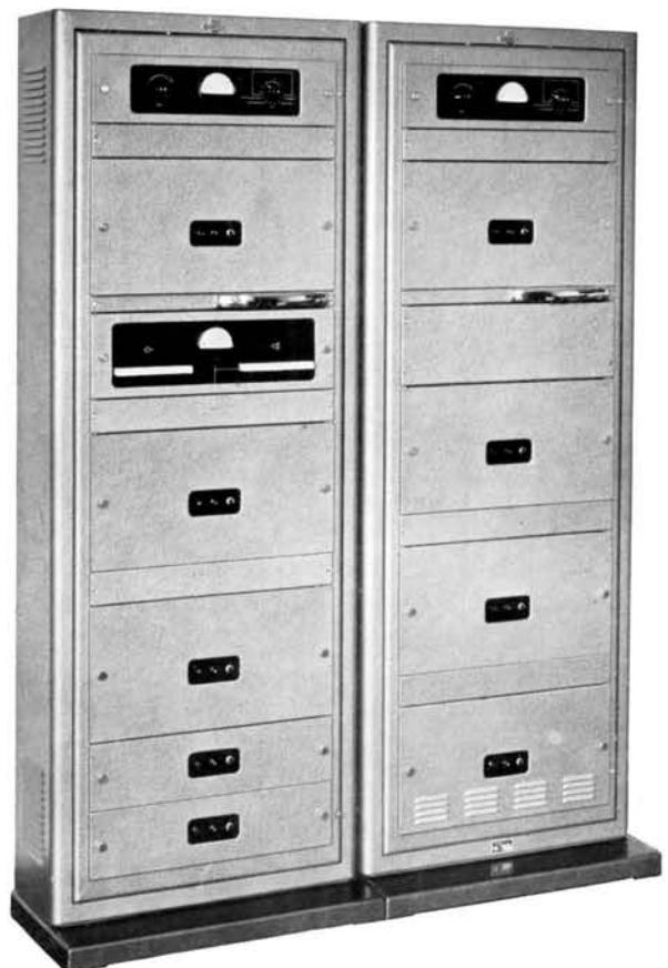
2 Hauptverstärkergestelle der Sechskanalanlage für Todd AO-Wiedergabe
